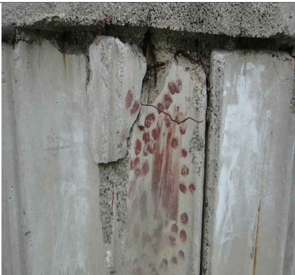
Рис. 3.9. Ушкодження у вигляді виколів і тріщин залізничної підпірної стінки.
