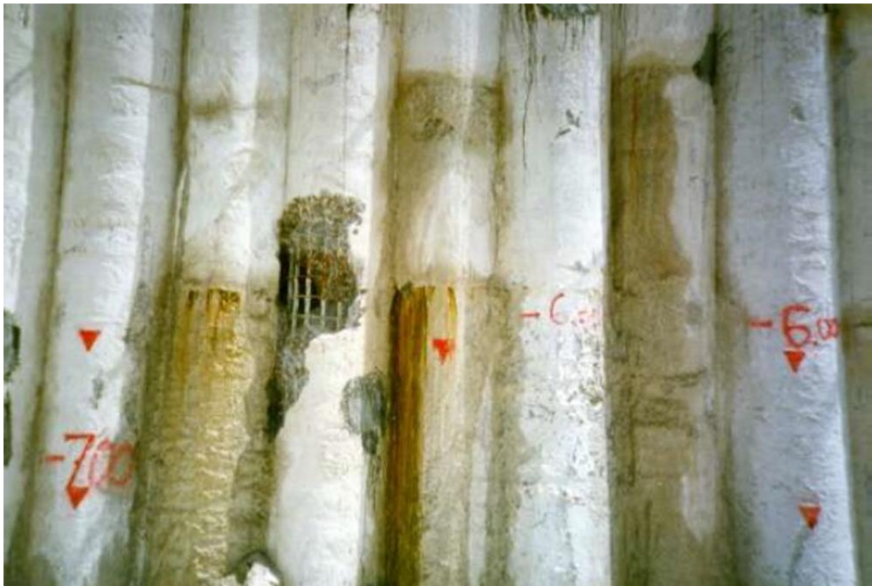
Рис. 1.16 Дефекты в палях ( фактичне зображення ) [172].
