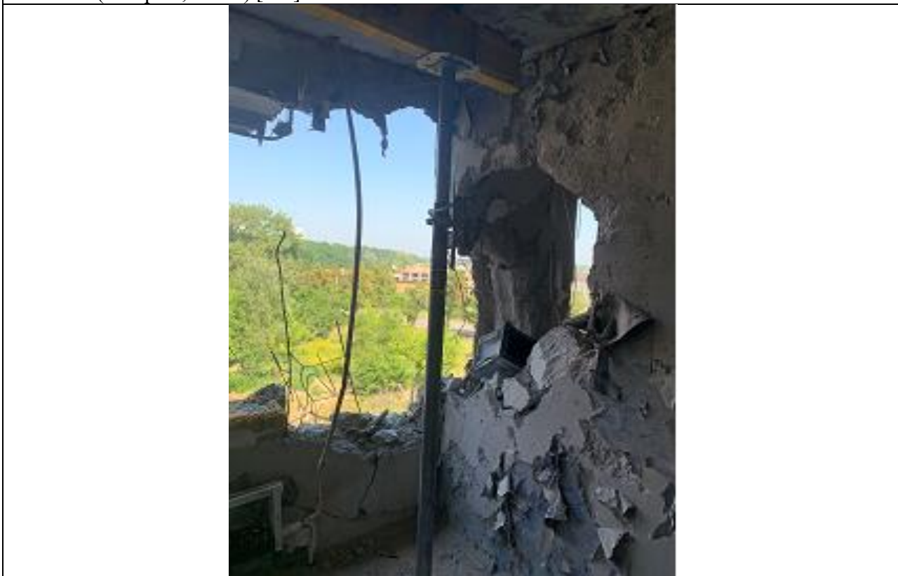
Рис. 4.11. Локальні руйнування бетону та арматурних стрижнів внутрішніх стінових панелей в осі Ж/15 (поверх 5, кв. 55) [197]
