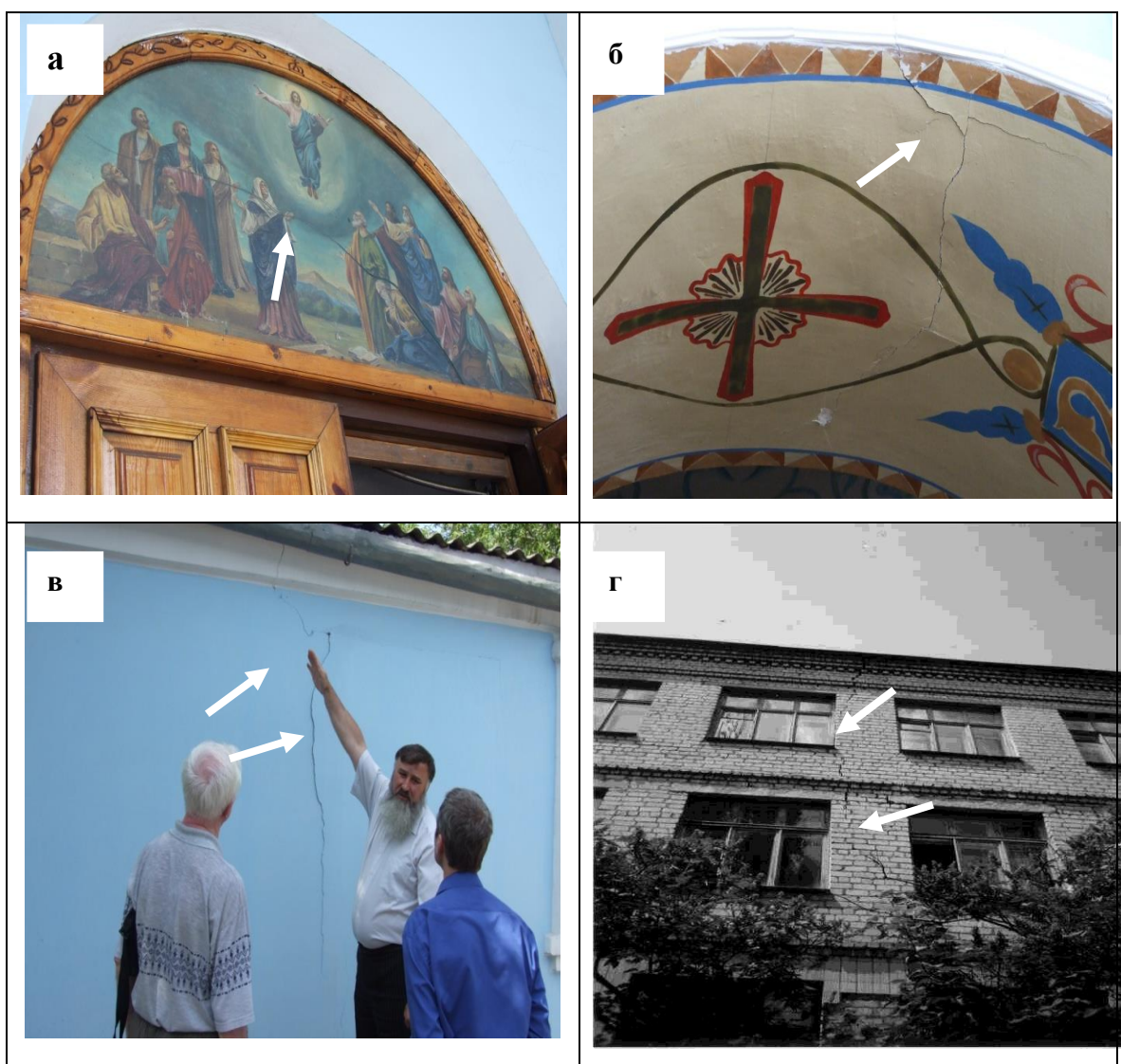
Рис. 4.2. Випадки порушення будівель від промислових вибухів у Кривому Розі. (фотографії Калюх Ю.І.)
