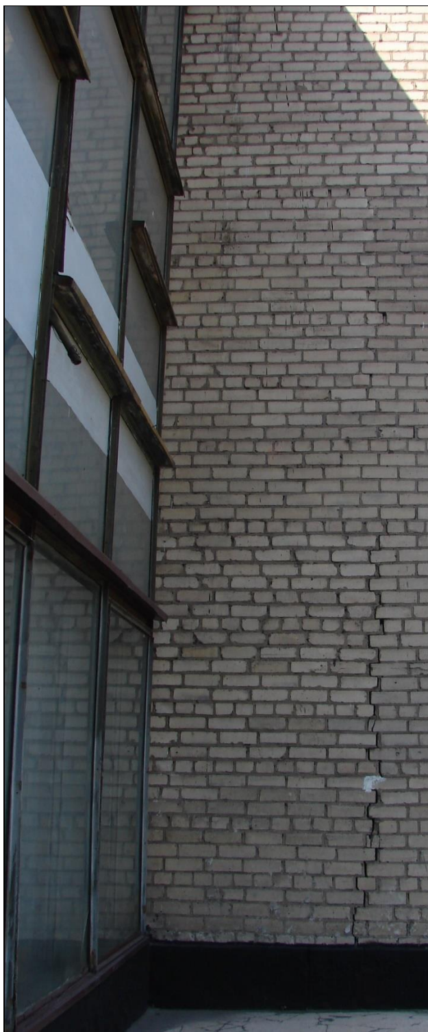
Рис. 1.3 Тріщина з шириною розкриття до 1 см у нижній частині правої поперечної стіни біля центрального вітража будівлі Центру дитячої та юнацької творчості «Мрія» внаслідок дії промислових вибухів у кар'єрі ВАТ «ПівдГЗК» у м. Кривий Ріг (2008 р.). (фото Калюха Ю.І.)
