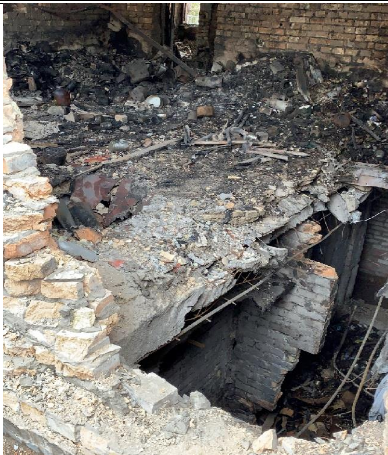
Рис. 4.9. Зруйновані плити перекриття над підвалом, пошкодження цегляних перегородок [196]
