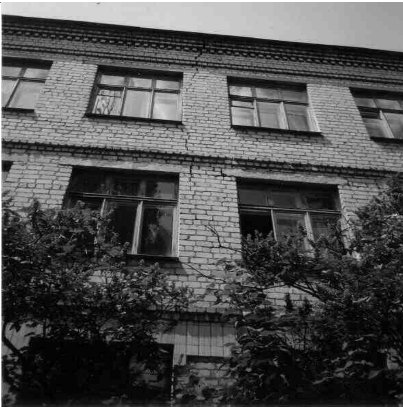
Рис. 1.2. Ушкодження будівлі середньої школи № 40 по вул. Сестроріцькій внаслідок дії промислових вибухів на кар'єрах ВАТ «Північний ГЗК» у м. Кривий Ріг (2005 р.). (фото Калюха Ю.І.)
