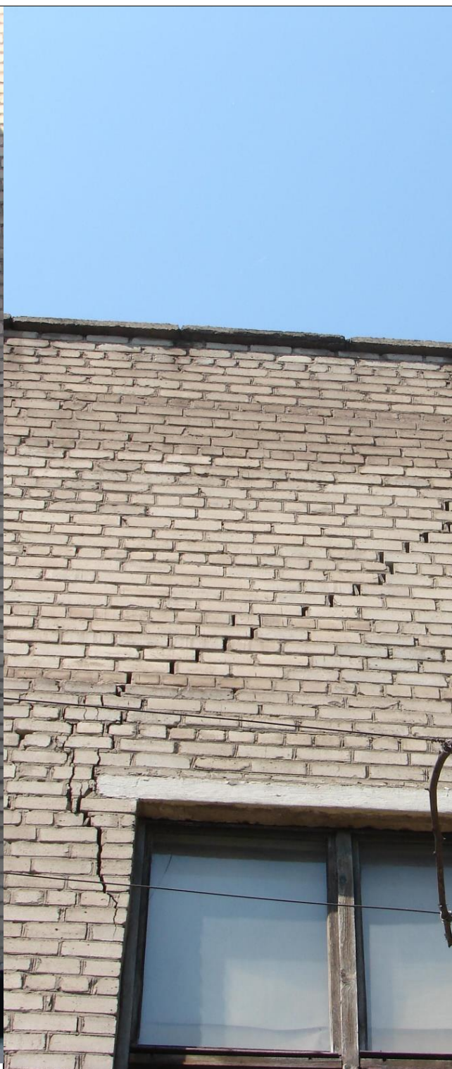
Рис. 1.4 Тріщина з шириною розкриття до 1 см у верхній частині стіни лівого бічного фасаду будівлі Центру дитячої та юнацької творчості «Мрія» внаслідок дії промислових вибухів у кар'єрі ВАТ «ПівдГЗК» у м. Кривий Ріг (2008 р.). (фото Калюха Ю.І.)
