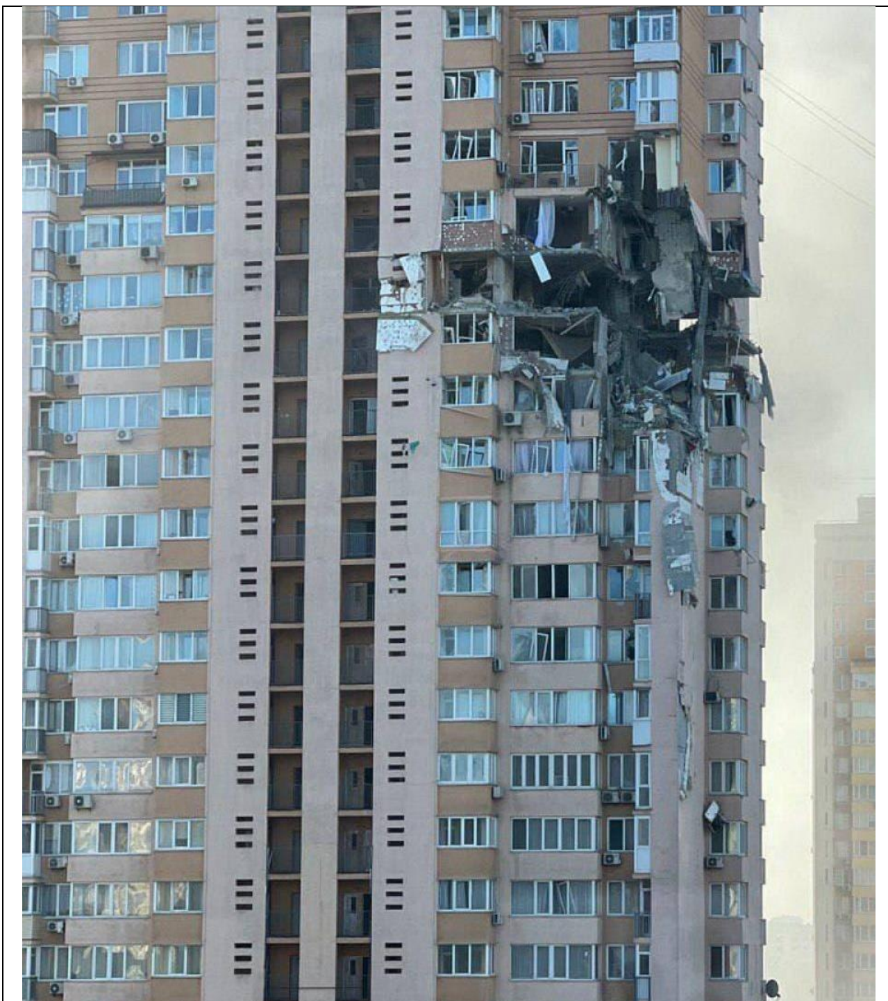
Рис. 4.7. Загальний вигляд зруйнованої частини будинку – фасад в осях К-ІІ/8-1 [176]
