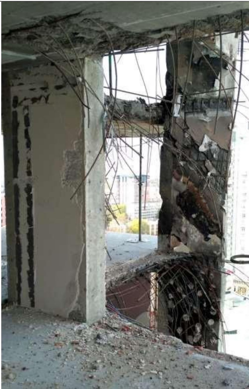
Рис. 3.3. Пілони у рівні 19 поверху: практично не пошкоджений в осях 3/Ж (зліва), сильно пошкоджений в осях 2/Ж (справа). Зруйнована (обвалена) ділянка перекриття в осях 2–3/Ж–И. Сліди пожежі на поверхні пілона 2/Ж [176]
