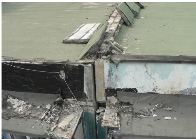
Рис. 2. Замикання деформаційного шва між 9-поверховими житловими будинками в м. Запоріжжя.
