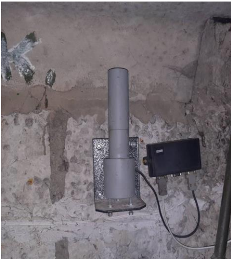
Рис. 14. Зовнішній вигляд датчика УІД, встановленого на стіні в підвалі об'єкта.
