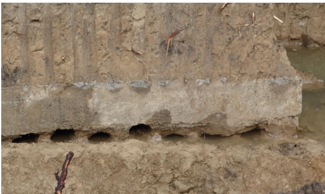
Рис. 2.34. Характер контурів свердловин у процесі технологічного осідання стрічкового фундаменту при усуненні крену будівлі.
