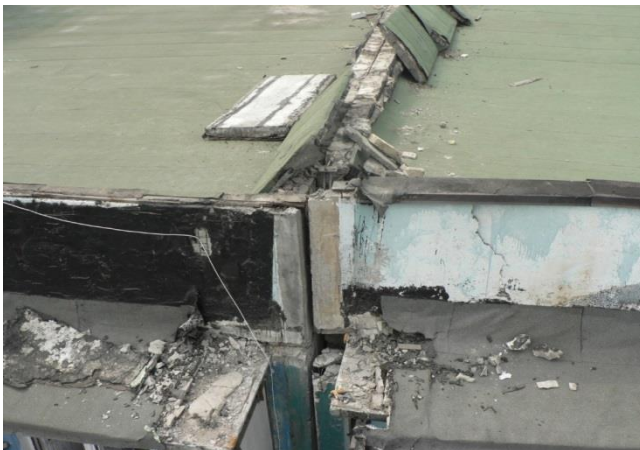
Рис. 0.2. Замикання деформаційного шва між 9-поверховими житловими будинками в м. Запоріжжя.
