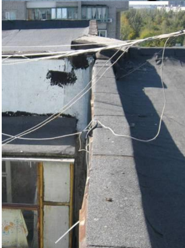
Рис. Г2. Закриття деформаційного шва та спирання блок-секції № 3 житлового будинку № 23 на блок-секцію № 1 житлового будинку № 25 (а, б).
