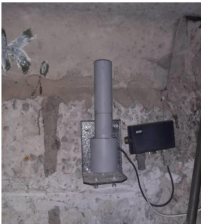
Рис. 4.1. Зовнішній вигляд датчика УІД, встановленого на стіні в підвалі об'єкта.
