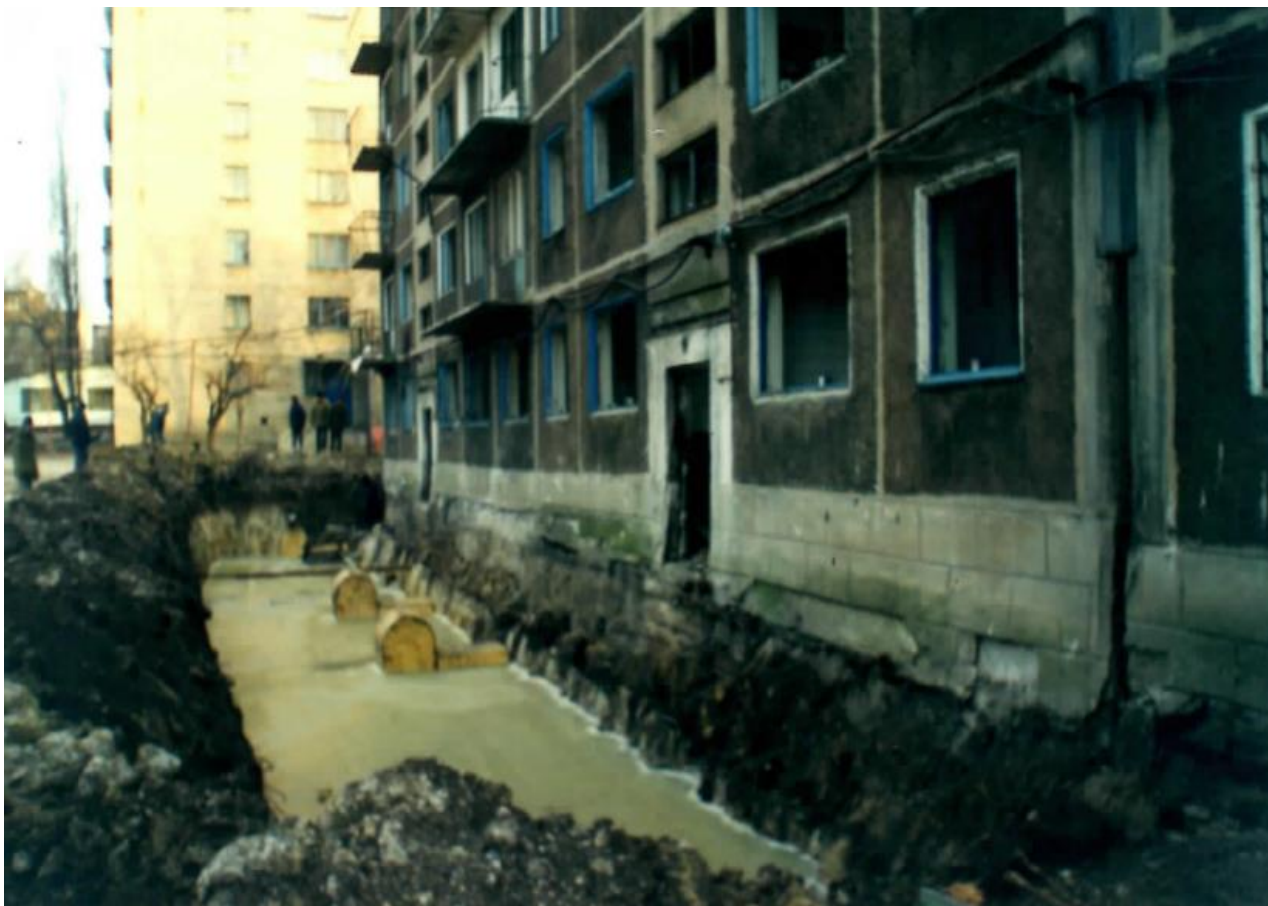
Рис. 0.3. Затоплення котловану з буровим обладнанням при виконанні робіт з усунення крену п'ятиповерхового крупнопанельного будинку внаслідок аварійного прориву водопроводу (м. Селідово, Донецька обл., 2002 р.)
