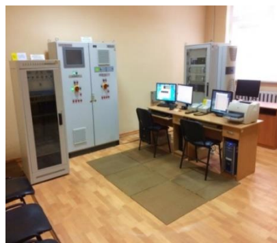
Рис. 2. Зовнішній вигляд апаратного залу станції УНСП-8.2
