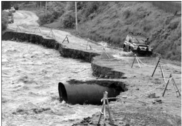
Рис. 7.13. Будувати дороги вздовж русел річок небезпечно: після кожного паводку їх треба відбудовувати. Краще перенести автодорогу вище, мінімум на 20 м, щоб паводок до неї не піднявся, і побудувати якісну автодорогу один раз і назавжди. Джерело: BBC.com
