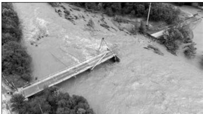
Рис. 7.5. Паводок 2020 р. зруйнував мости, побудовані після паводку 2008 р. Джерело: Новини DW
