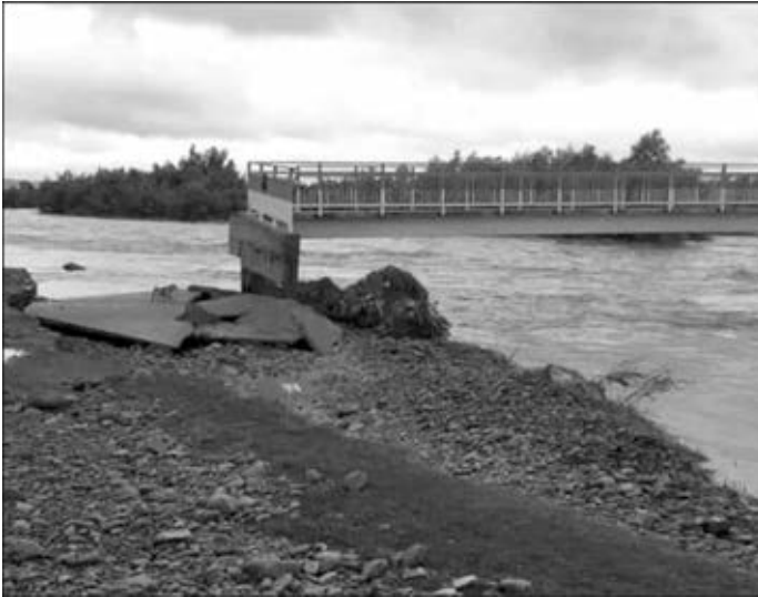
Рис. 7.14. Мости потрібно будувати, опускаючи їх опори до корінних порід, тобто на 5—10 м глибше, ніж це робиться зараз, тоді напір паводкової води не зможе змити міст. Джерело: 24 Канал TV
